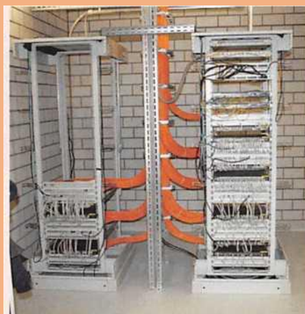
Gebäudeverteiler mit Etagenverteiler
