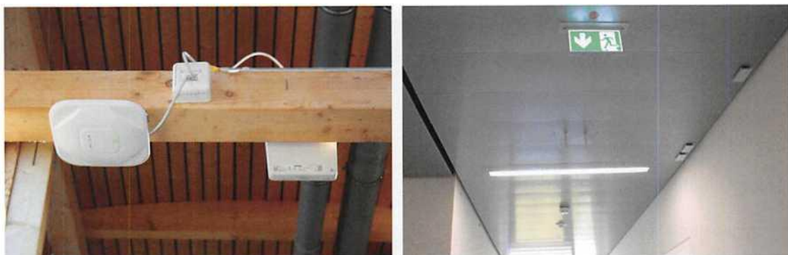
Sichtbarer Access Point mit Basisstation für das DECT-Funktelefon
