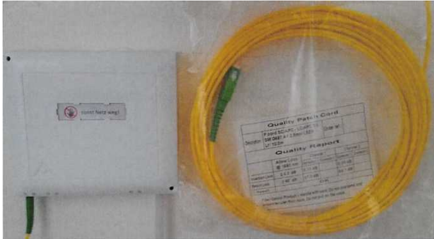
Glasfaseranschluss im Hausübergabepunkt mit Lichtwellenleiter
