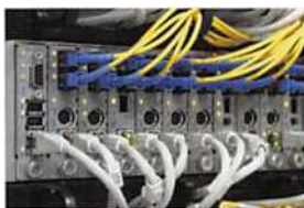
Verkabelung mittels Lichtwellenleiter
