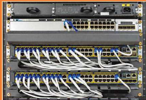
19-Zoll-Rack in einem Anschlussraum mit zwei Cat6-Patch-Panels und zwei Switches
